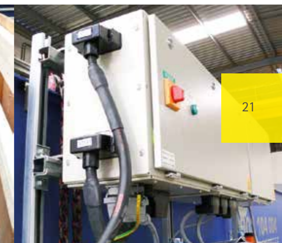
Quadro elettrico con connettori
