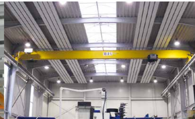
Gru a ponte con carrello monotrave
